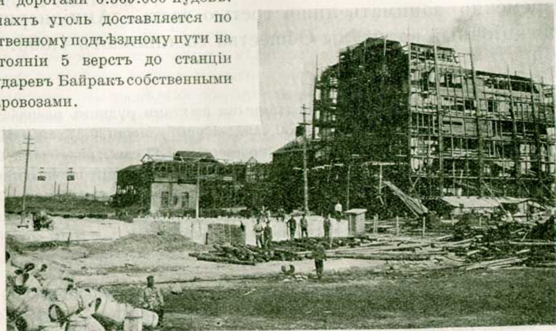
Промывательная фабрика съ проволочной дорогой.
