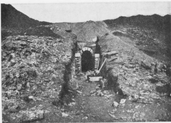
Рис. 50. Подвал Станции. Подземная вентиляционная галерея. Место выхода галереи на дневную поверхность, где туннель переходит в открытую канаву, стены которой выложены дикарным камнем на глине, с устройством цилиндрического свода из штучного камня и с засыпкой канавы поверх свода землей. Снимок сдѣлан со стороны лимана.
