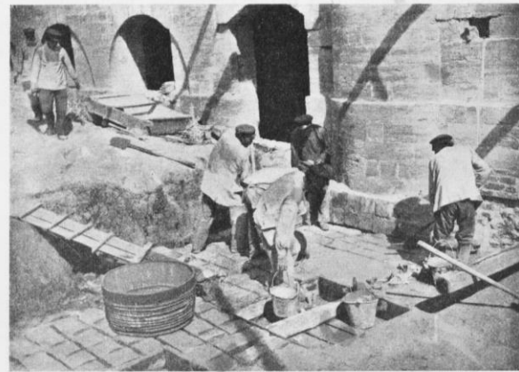
Рис. 34. Подвалъ Станціи. На снимкѣ изображенъ моментъ заливки плоскаго каменнаго перекрытія надъ котельной подвала жидкимъ цементнымъ растворомъ (см. стр. 25, рис. 16). Растворъ спѣшно заливается изъ перерѣзовъ бочекъ (при постоянномъ перемѣшиваніи) и разравнивается по поверхности перекрытія деревяннымъ скребокъ; во время опорожненія одного изъ перерѣзовъ черноработіе заполняютъ второй. На переднемъ планѣ снимка видны квадратныя люки въ котельное помѣщеніе.
